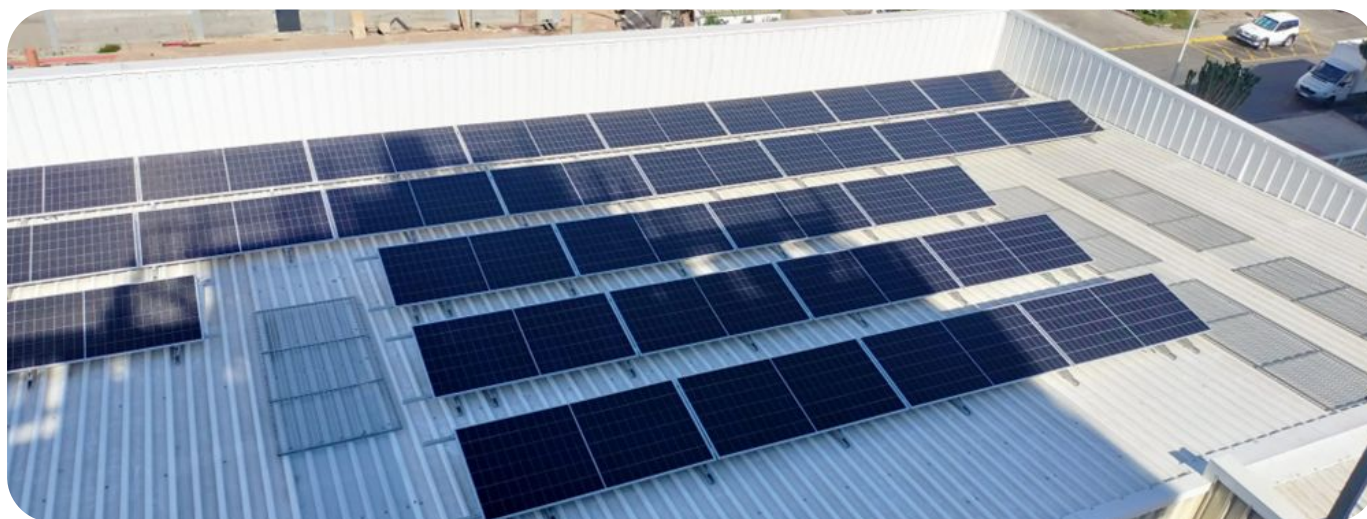
Instalación fotovoltaica, planta de Arinaga | Gran Canaria
