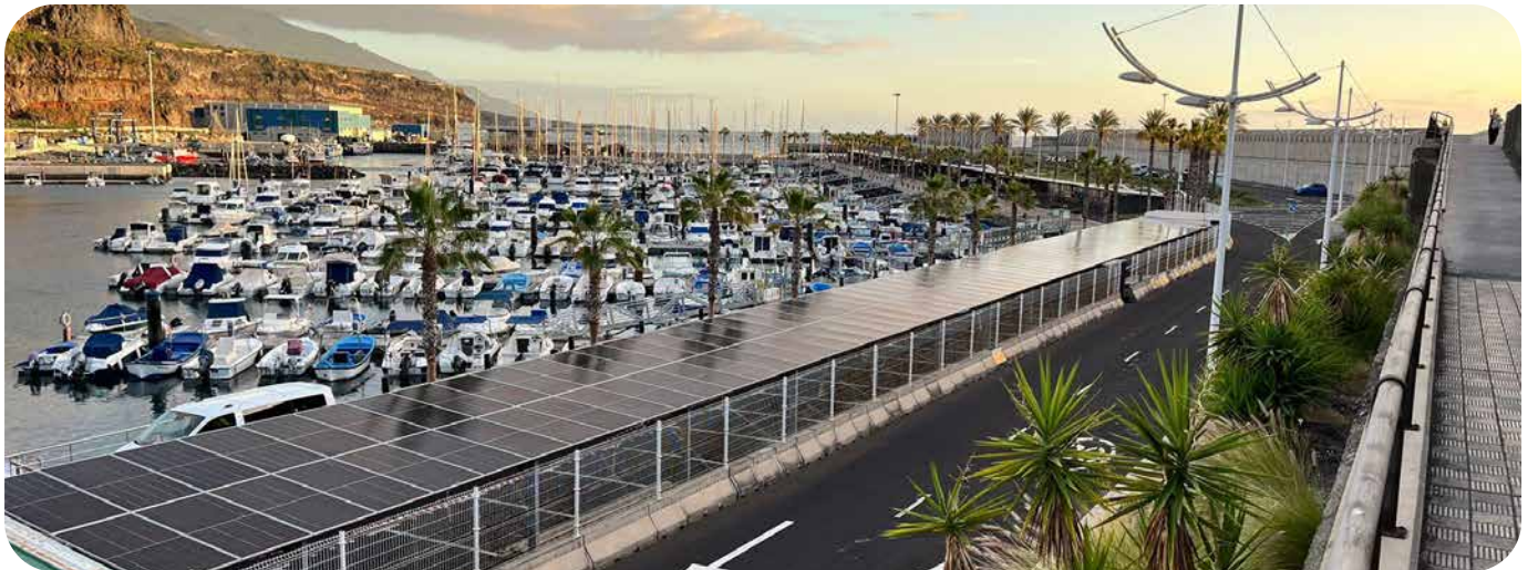
Instalación fotovoltaica, Puerto Tazacorte | La Palma
