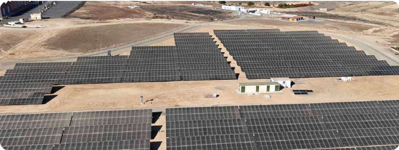
Instalación fotovoltaica El Charco, Tuineje | Fuerteventura
